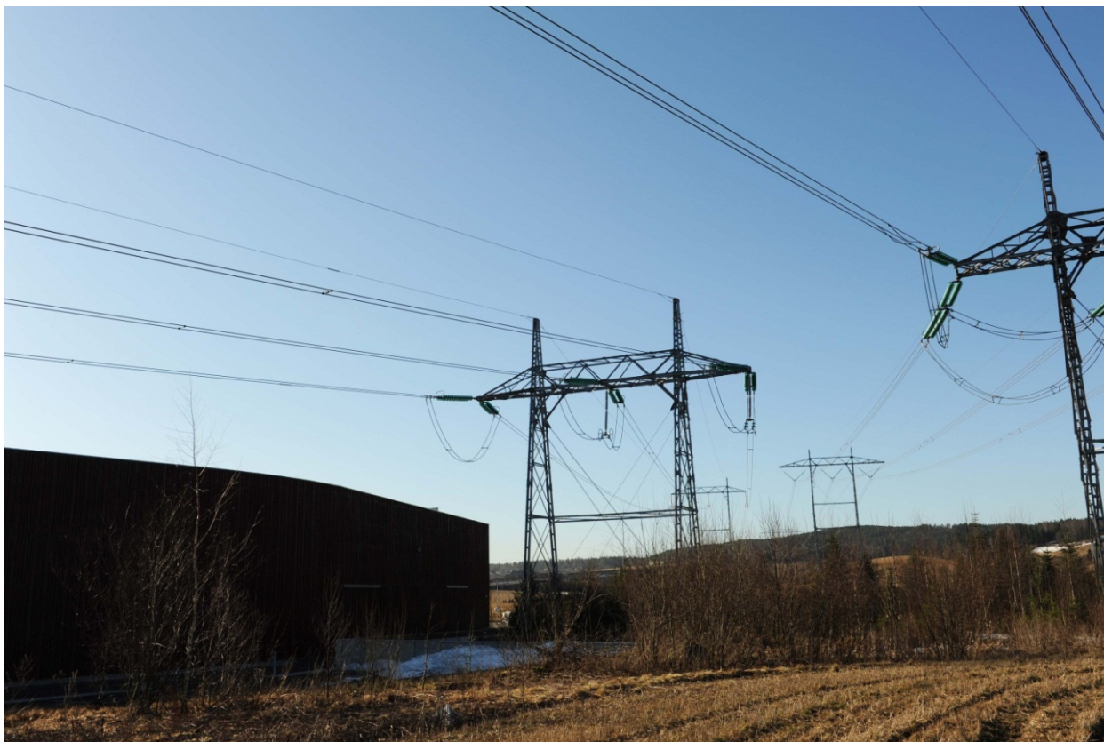
Figur 1. Bilde av to 420 kV-ledninger i Akershus. Ledningen til venstre har duplex linetverrsnitt, mens den til høyre har triplex.
