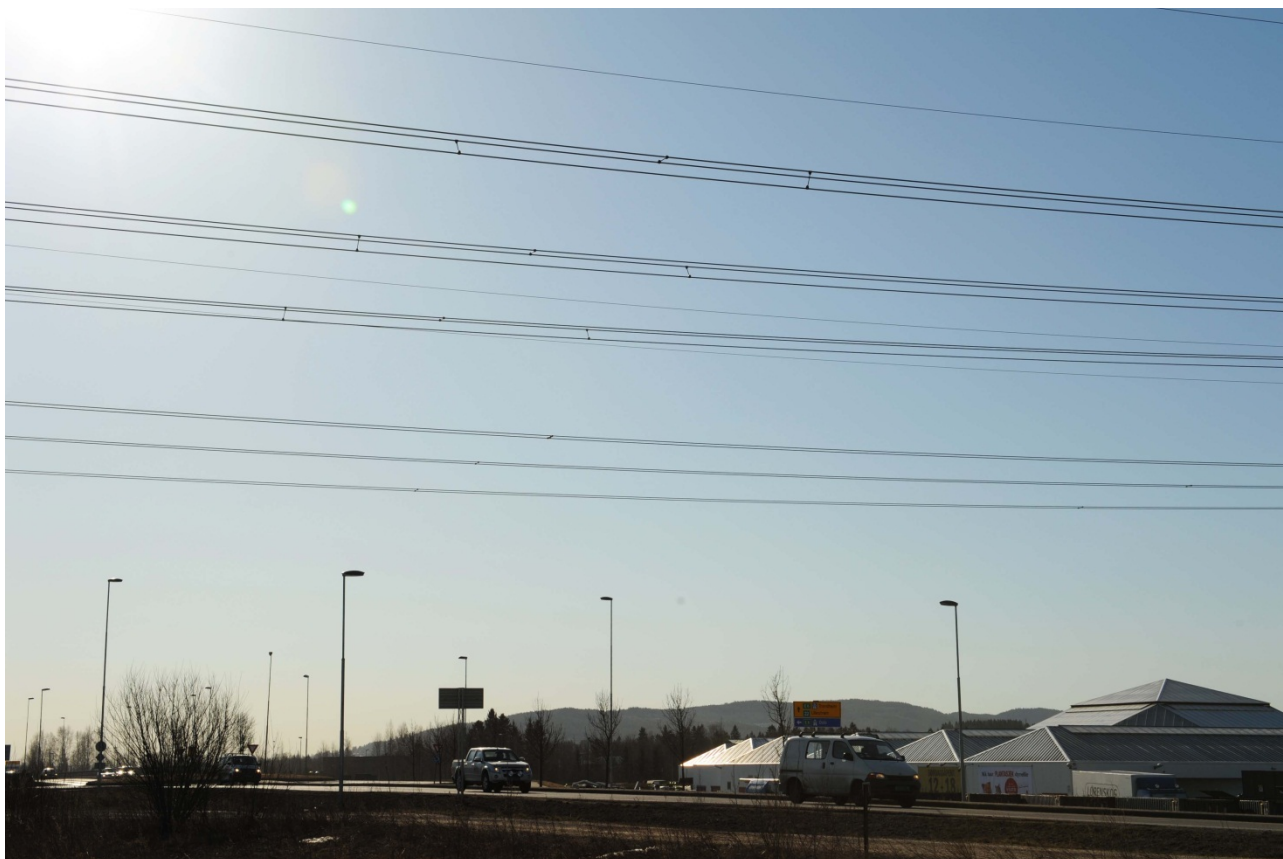
Figur 2. Duplex og triplex-ledninger går her parallelt. Triplex-ledningen er nærmest kamera, og fremstår derfor tydeligere på bildet.
