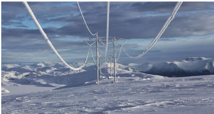
Sima-Samnanger: økte kapasiteten mot Bergensregionen. Ledningen går gjennom meget harde værforhold med spesielt store islaster.
