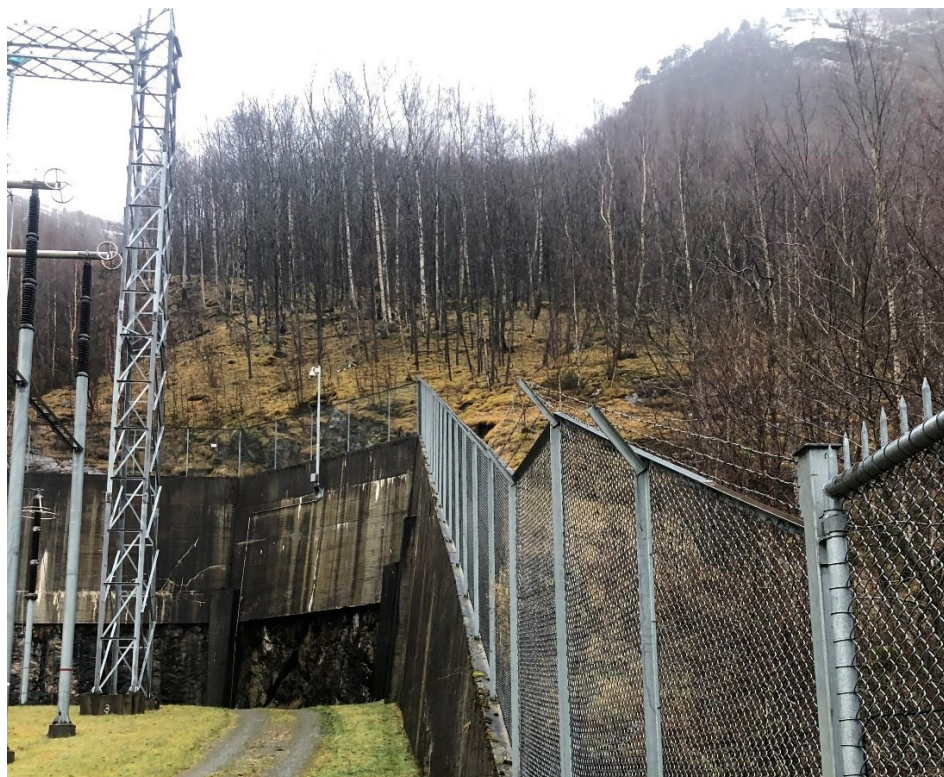
Figur 4. Støttemur rives og forlenges mot vest for å gi plass til nye felt mot høyre i bildet
