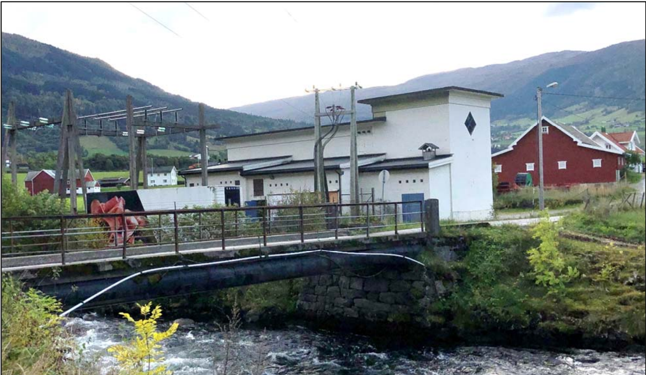
Figur 4-2: Vik sentrum, lokal transformatorstasjon.
