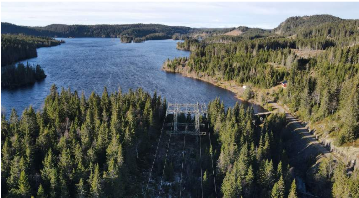
Figur 4-49 Koblingsanlegget sør for Søndre Heggelivatnet. Dette har vært ute av drift siden 1940-tallet og fungerer kun som vanlig mast (stativ). Til høyre i bildet ligger det som kan være ledningshytta fra anleggstiden. Foto sett nordover.
