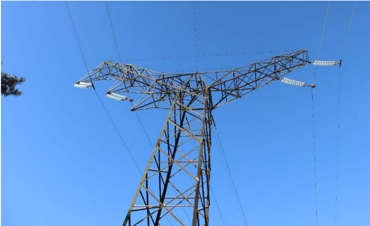
Figur 4-33 Mast nr. 249, vinkelmast. Bemerk snutene i ytterkant av vinkelen som er montert for å sikre tilstrekkelig avstand mellom line og travers. På de ytterste fasene er ledningene opphengt med bølgeklammer (jf Figur 4-41).
