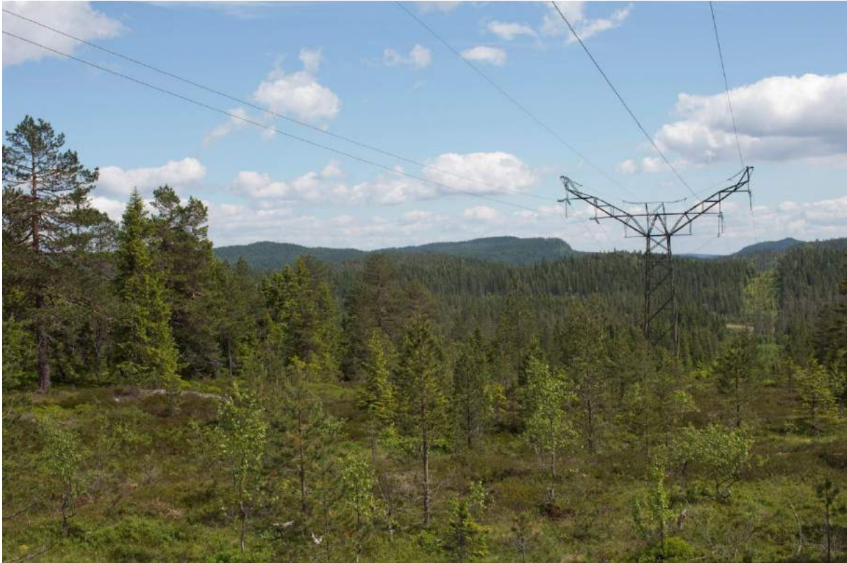
Figur 4-41 Revolveringsmast (nr. 268) ved Løvlia. Total mastehøyde 22,6 meter. Foto: Statnett
