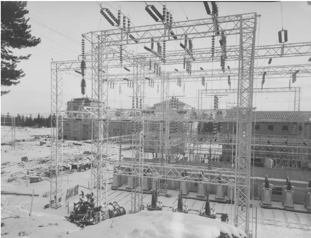
Figur 4-50 Innstrekkestivet ved Smestad transformatorstasjon fotografert av A. B. Wilse i 1929. Kilde: DigitaltMuseum
