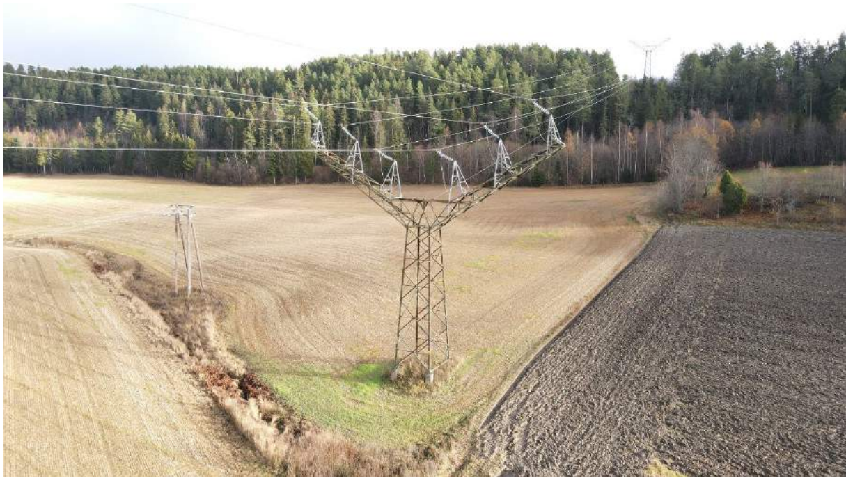
Figur 4-28 Oppstrekkmast ved Ultvedt (nr. 243). Total mastehøyde 20,5 meter. Foto mot sørøst.
