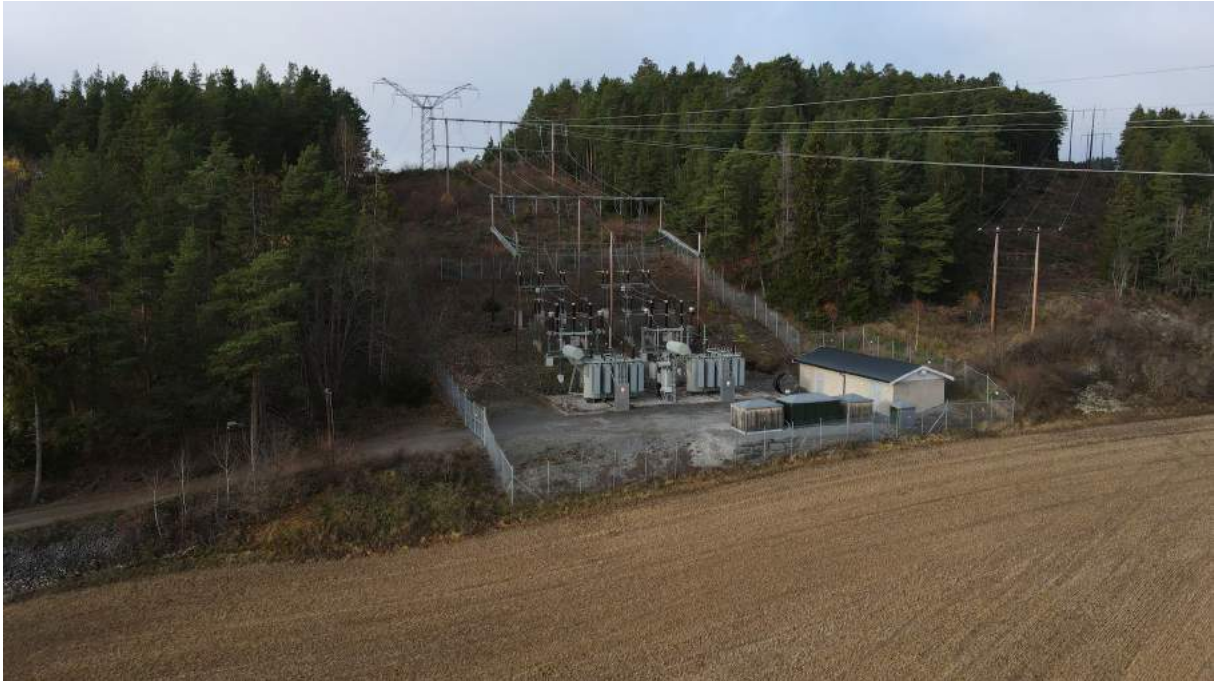
Figur 4-8 Ultvedt transformatorstasjon sett mot nordvest.
