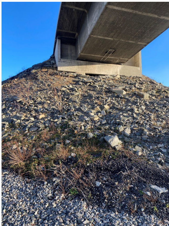
Figur 12: Bildet viser det sørlige området under Rongsundet bru. Området må tilrettelegges for å få tilgang til brua for å få gjennomført arbeidene. Området er markert som riggplass R14 i detaljkart. Kilde: Statnett, 2021
