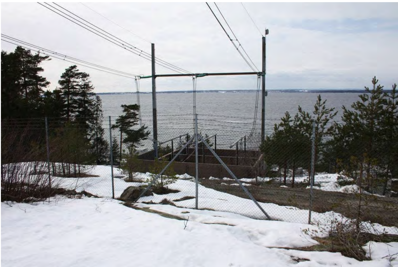
Figur 5. Eksempel på muffestasjon med åpen løsning, lik den som er planlagt i Rissa. Bildet er fra en av Oslofjordforbindelsene. Muffestasjonen ved Agdenes vil inneholde de samme komponentene, men til har en beskyttende betongvegg rundt anlegget. (foto: Statnett).
