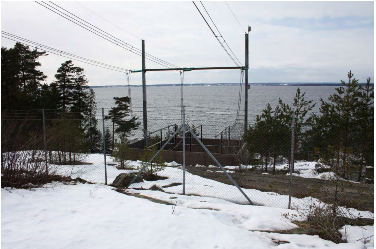
Figur 4. Eksempel på muffestasjon med åpen løsning, lik den som er planlagt i Rissa. Bildet er fra en av Oslofjordforbindelsene. Muffestasjonen ved Agdenes vil inneholde de samme komponentene, men til har en beskyttende betongvegg rundt anlegget. (foto: Statnett).
