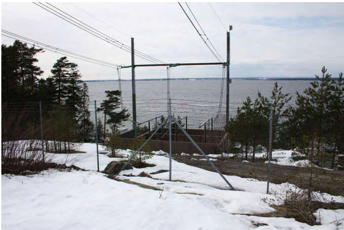
Figur 5. Eksempel på muffestasjon med åpen løsning, lik den som er planlagt i Rissa. Bildet er fra en av Oslofjordforbindelsene. Muffestasjonen ved Agdenes vil inneholde de samme komponentene, men til har en beskyttende betongvegg rundt anlegget. (foto: Statnett).
