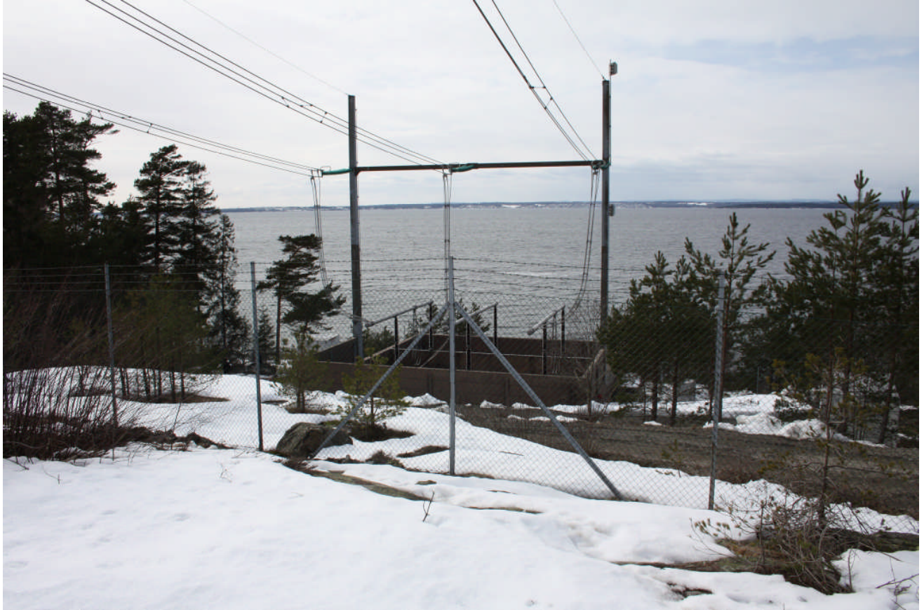
Figur 3.2.2: Eksempel på muffestasjon med åpen løsning, lik den som er planlagt i Rissa. Bildet er fra en av Oslofjordforbindelsene. Muffestasjonen ved Agdenes vil inneholde de samme komponentene, men til har en beskyttende betongvegg rundt anlegget. (foto: Statnett).
