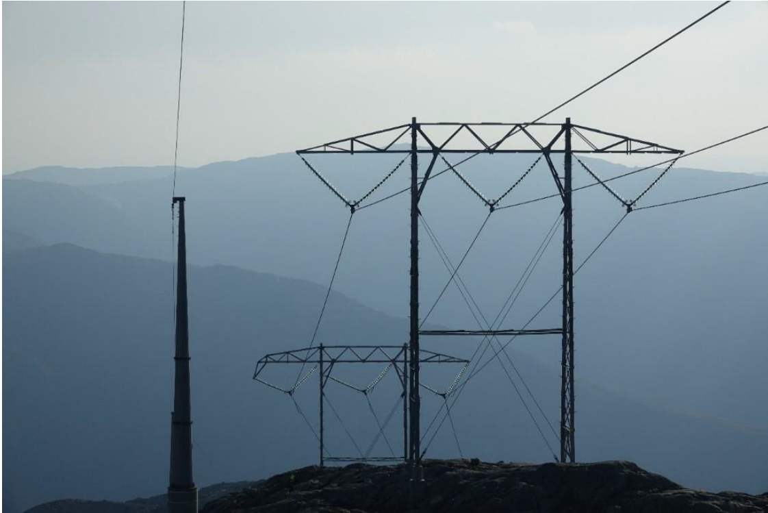
Figur 1. Eksempel på monomaststolpe for oppheng av OPGW til venstre i bildet.
