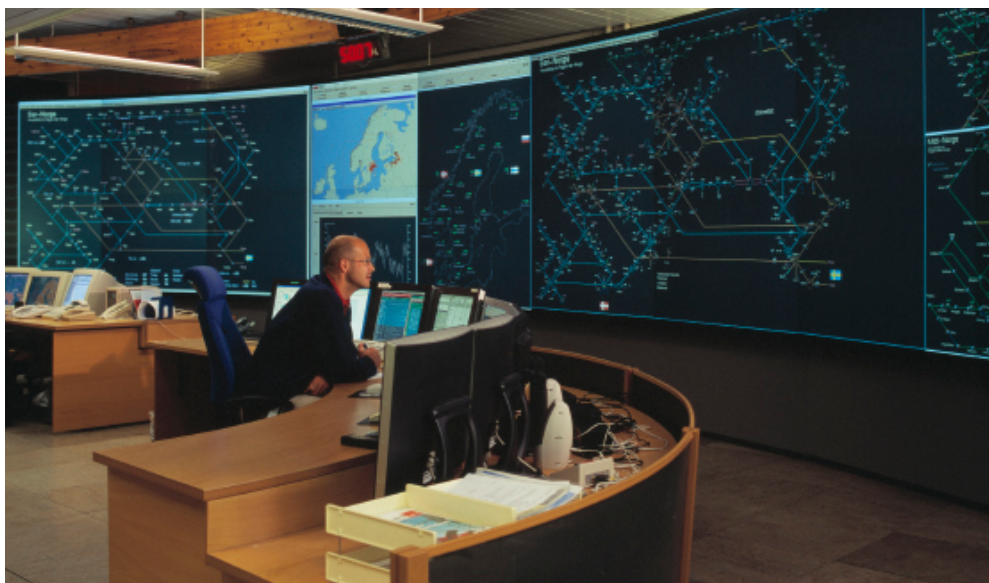
Systemansvar i operativ drift – Landssentralen.
