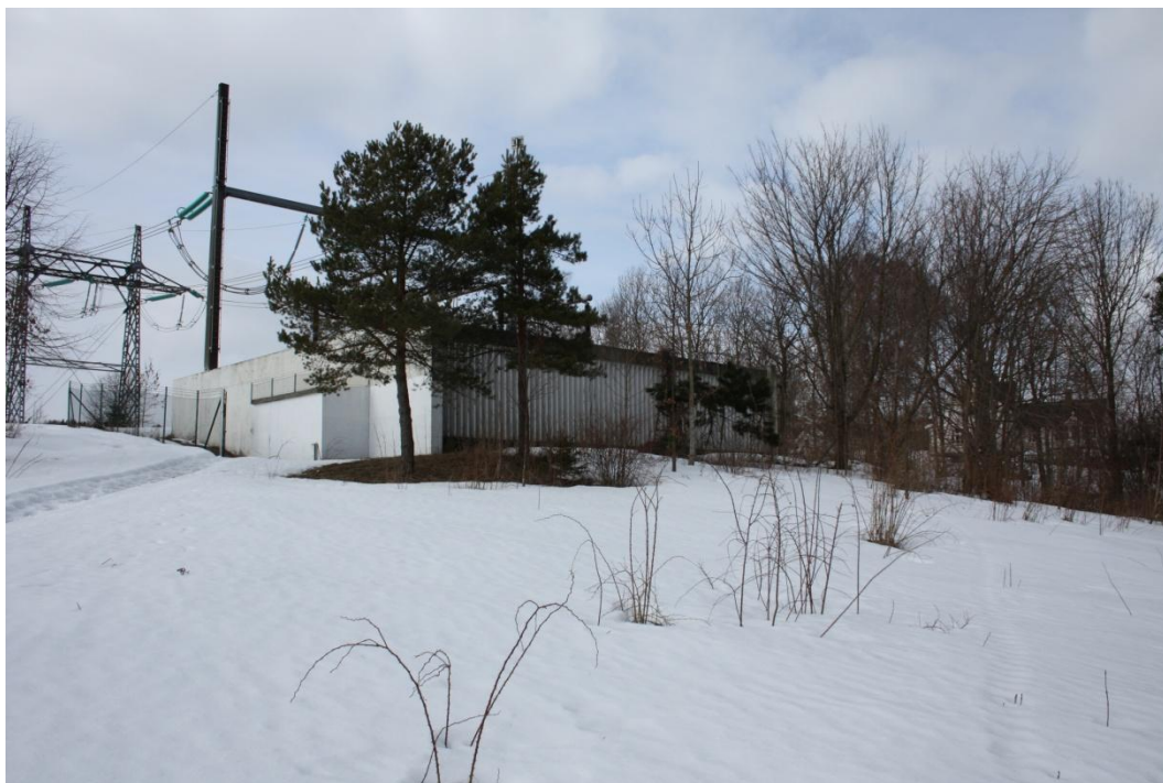
Figur 6. Eksempel på muffestasjon med lukket løsning, lik den som er planlagt i Agdenes. Bildet er fra en av Oslofjordforbindelsene. (foto: Statnett).
