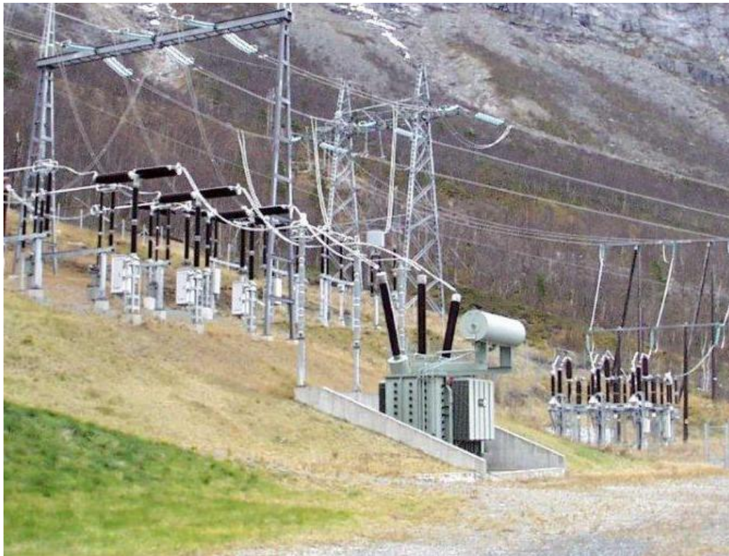
Figur 5. Eksempel på en reaktor, lik de som er planlagt i Rissa. Bildet er fra en reaktor i Salten i Nordland. Reaktoren er på 80 MVAR. De planlagte reaktorene i Rissa blir noe større (foto: Statnett).
