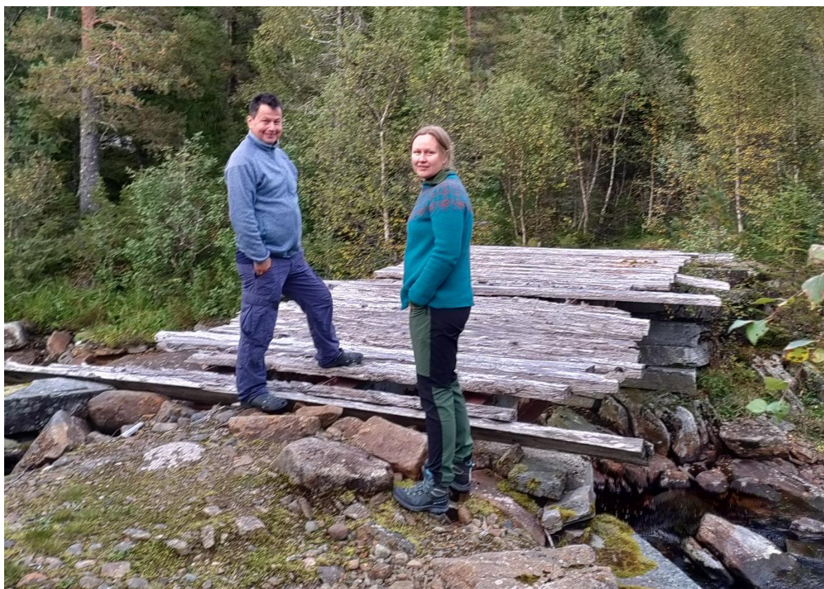
Figur 5-9 Dagens bru over Fessdalselva. Besøkt under befaring i september 2022. Leif Arne Jåma til venstre og Marit Østby Nilsen. Brua består neppe dagens HMS krav og passering av elva i dagens situasjon er derfor vanskelig. En sikring av brua kunne vært et kompensierende tiltak i forbindelse med bygging av 420 kV-ledningen.
