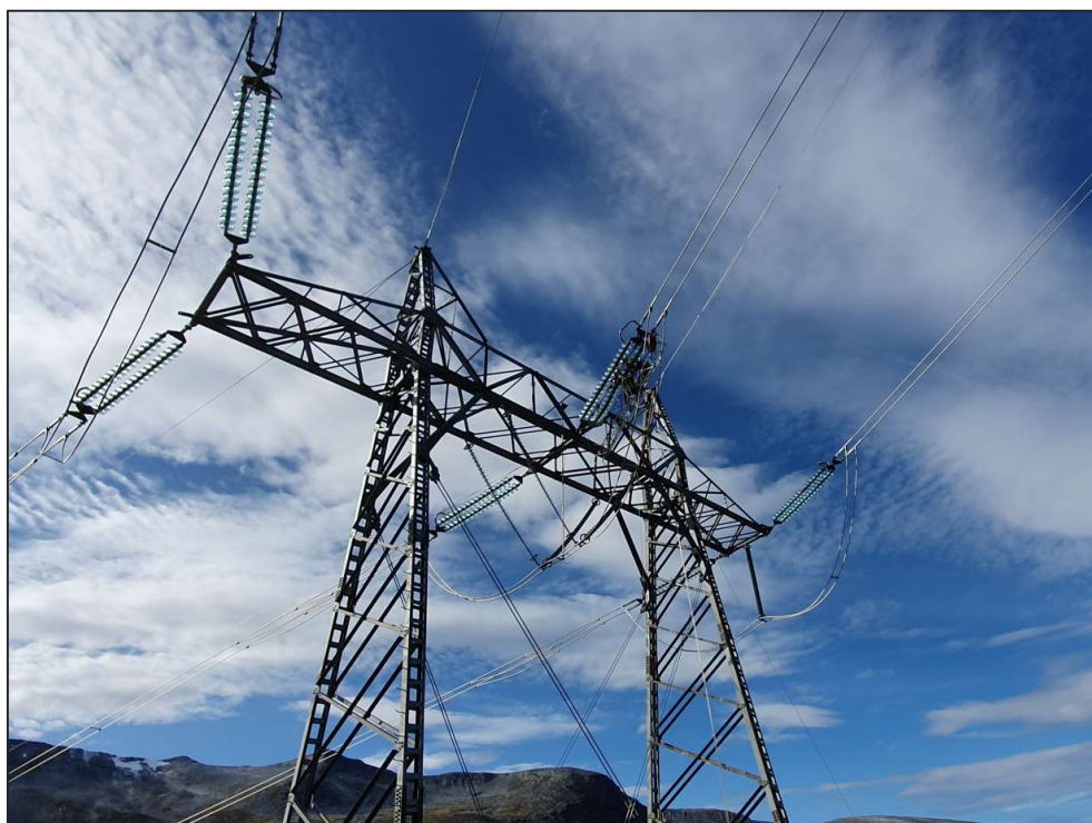
Figur 18: Nærbilde av mast med dupleks ledninger. Foto Statnett.
