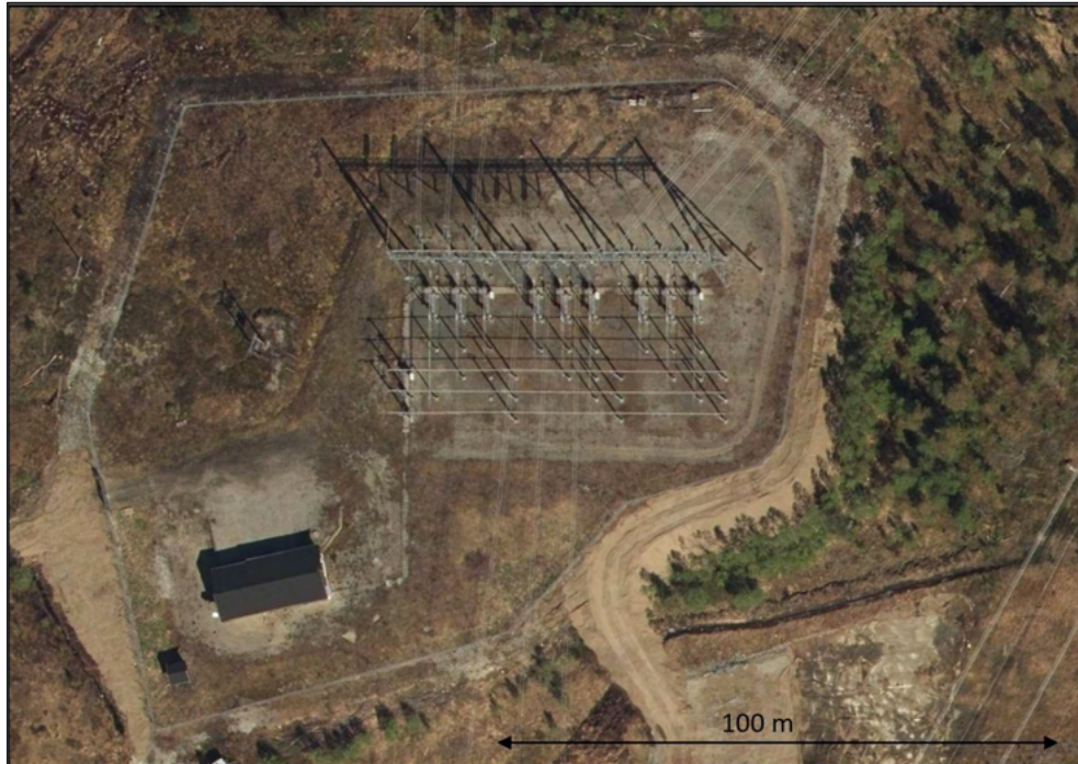
Figur 11: Eksempel på koblingsstasjon med tre ledningsfelt.
