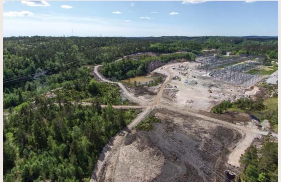
Figur 43 I noen tilfeller kan det, som her ved Kristiansand transformatorstasjon, være nødvendig å så for å stabilisere deponiet av myrmasse så fort som mulig.
