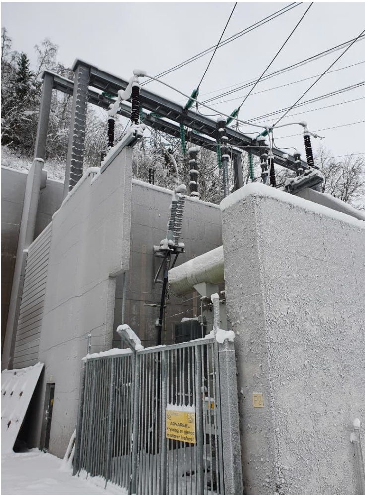
Figur 3: P-Spole nærmest i sjakt, og transformatorsjakt i bakgrunn
