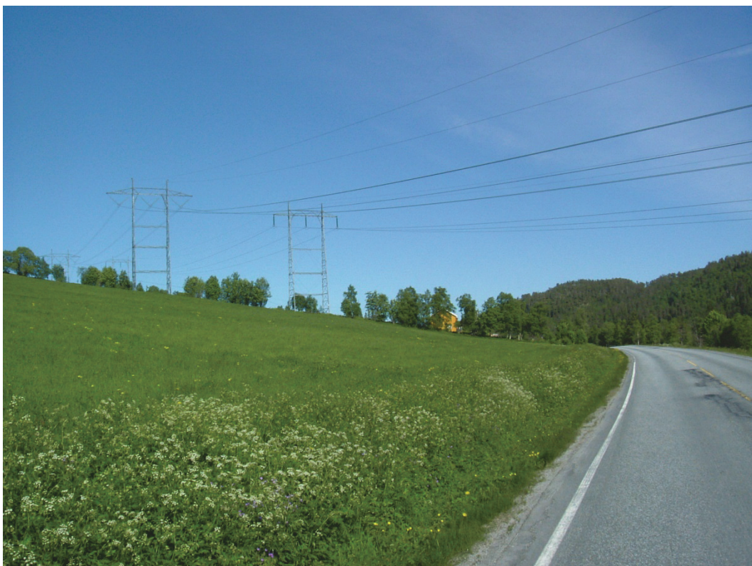
Figur 5 Parallellføring av eksisterende 420 kV-ledning (til venstre) og 300 kV-ledning gjennom Rindal.
