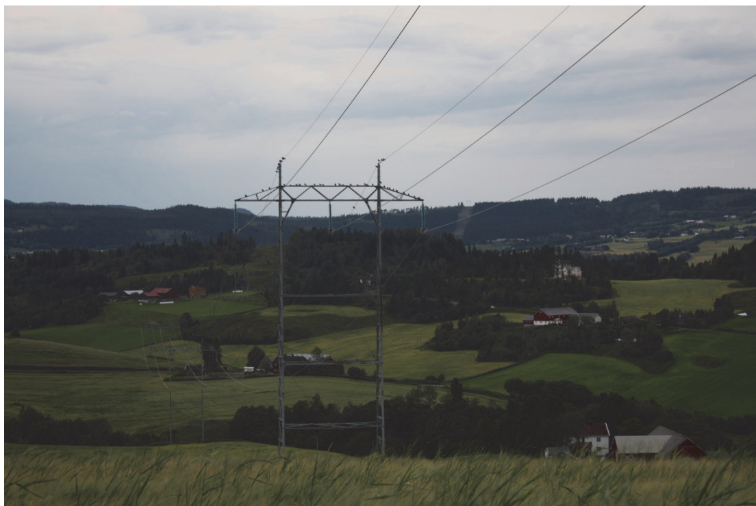
Figur 3 Eksisterende 300 kV-ledning ved Husby i Skaun.
