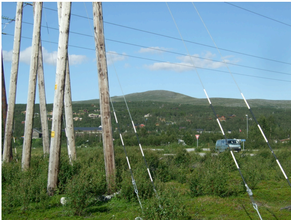
Hytteområdet på Skaidi, Kvalsund kommune, er allerede sterkt berørt av høyspentledninger. Foto: Morten W. Melby.
