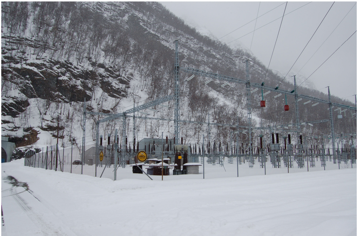
Figur 5-5: Eksisterende transformatorstasjon i Kåfjorddalen
