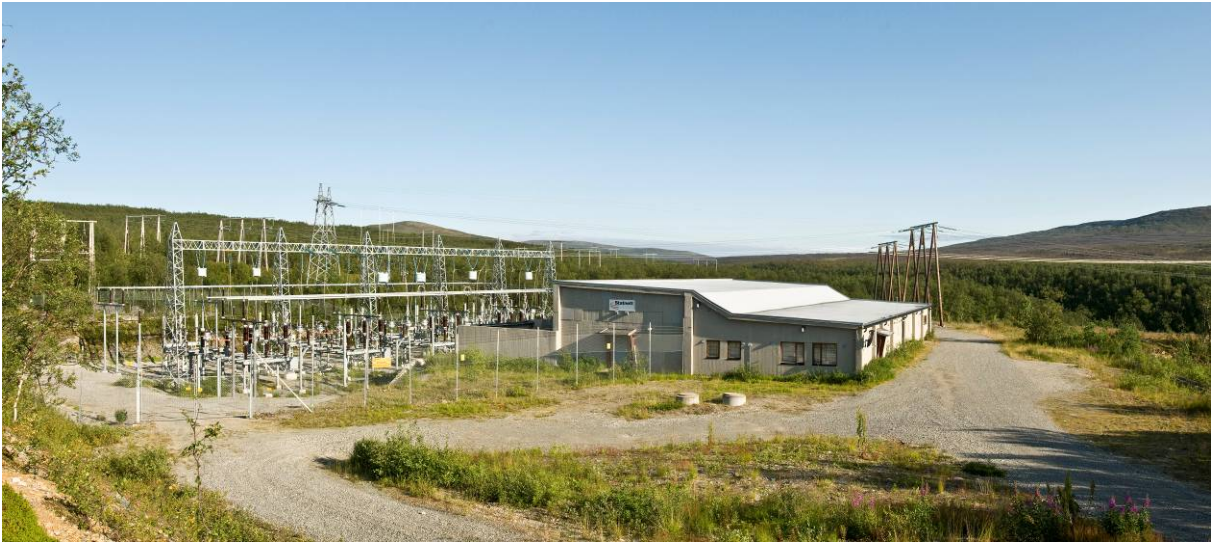
Figur 81: Skaidi transformatorstasjon. Foto: Einar Berg
