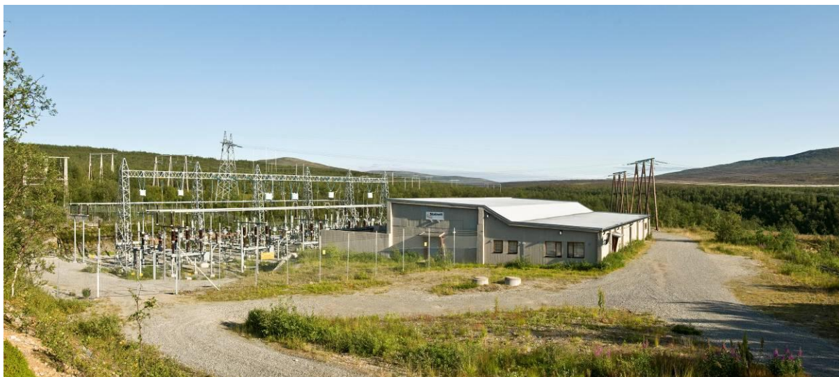
Figur 23: Eksisterende Skaidi transformatorstasjon. Foto: Einar Berg
