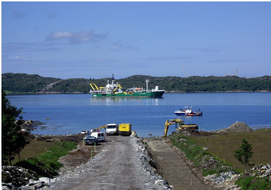
Figur 13 Eksempel på anleggsbelte for 420 kV jordkabel med ett kabelsett + reservekabel (totalt 4 kabler) i overgangen mellom jordkabel og sjøkabel
