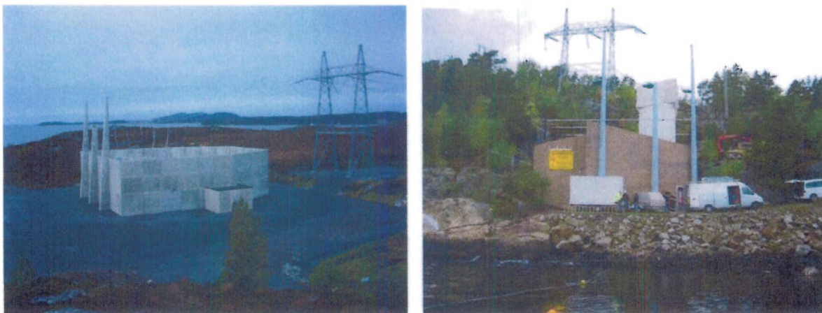
Bilde 1: Eksempel på muffestasjoner for overgang mellom kraftledning og kabel. Venstre bilde viser 420 kV for Nettilknytning Ormen Lange og høyre bilde viser 420 kV Solberg-Brenntangen, kabelforbindelse over Indre Oslofjord
