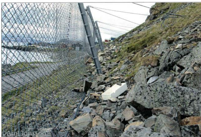
Figur 2. Eksempel på 4 m høyt steinspranggjerde som også viser netting, stolper og barduner.
