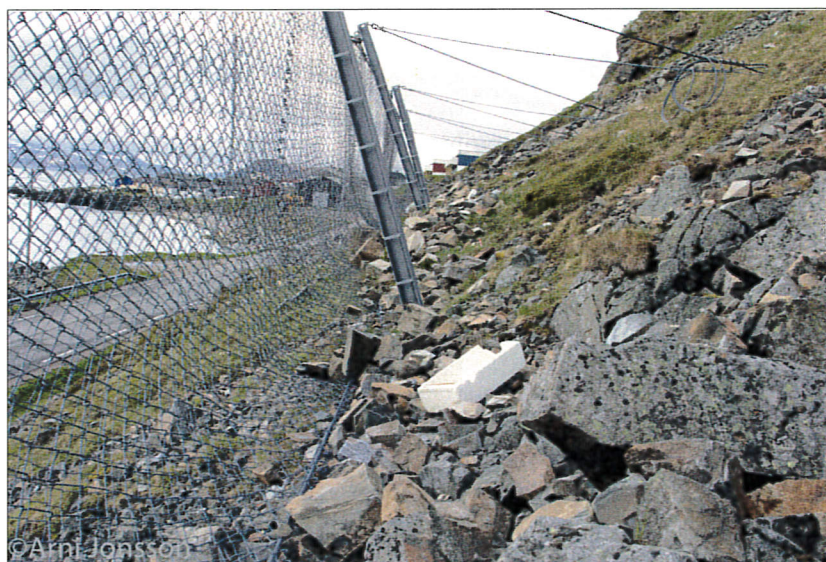
Figur 2. Eksempel på 4 m høyt steinspranggjerdet som også viser netting, stolper og barduner.
