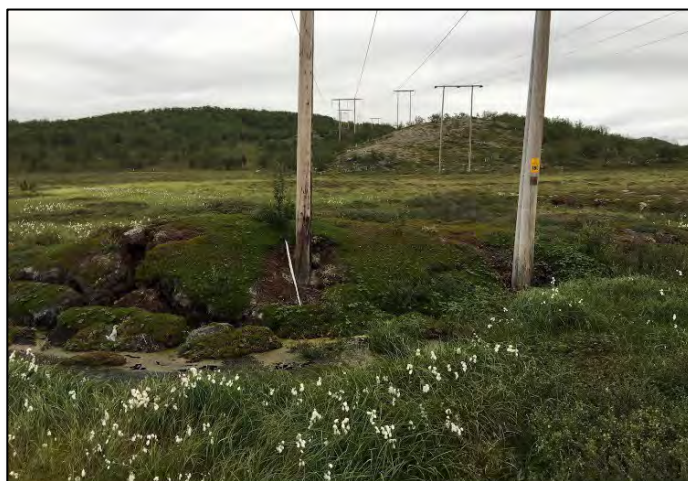
Figur 8: Foto av en mast for eksisterende 132 kV ledning som går gjennom Madarjeaggi, en palsmyr nord for Stabbursdalen.
