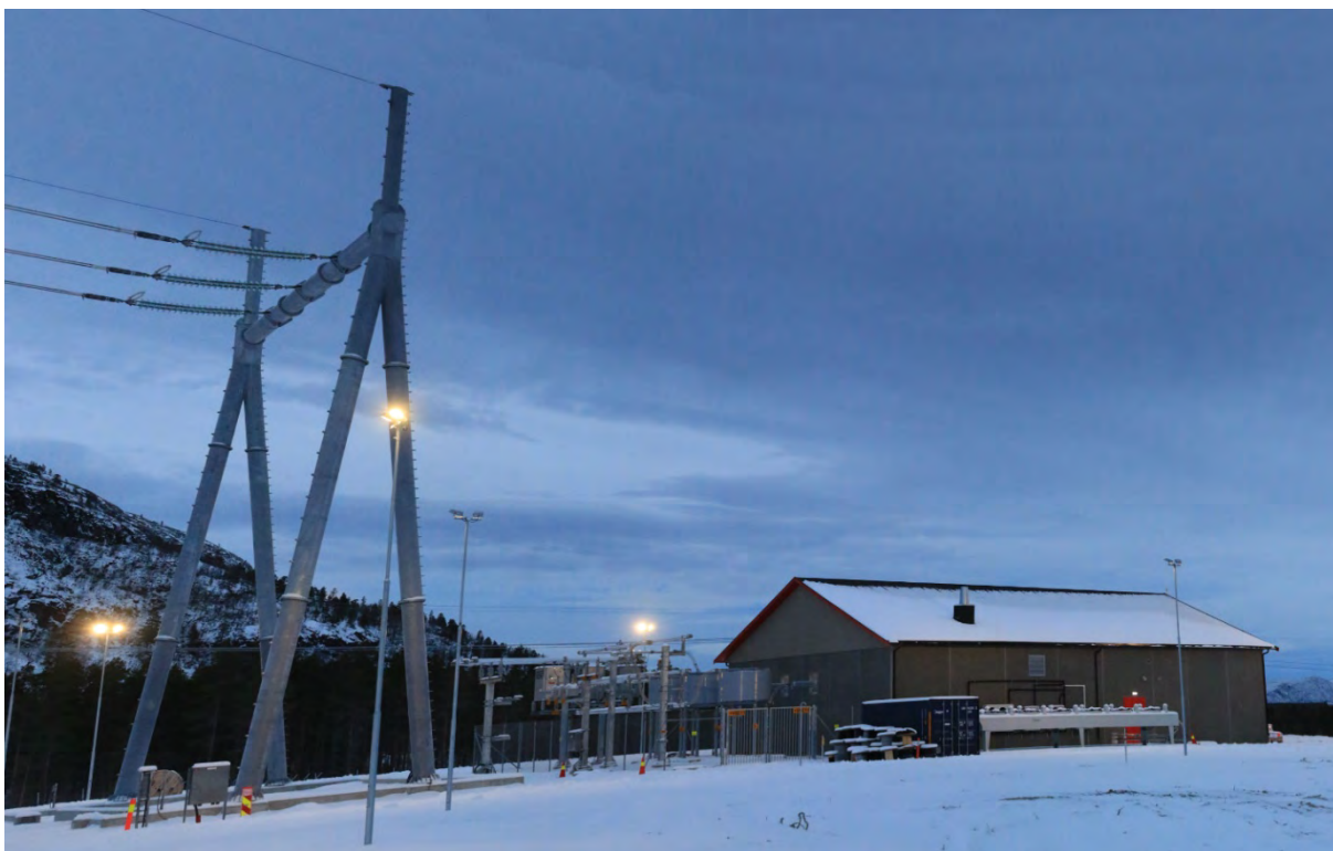
Figur 26: Bildet er et eksempel på et kompenseringsanlegg med transformator til venstre, apparatanlegg og i bakgrunnen ses SVS-bygget.
