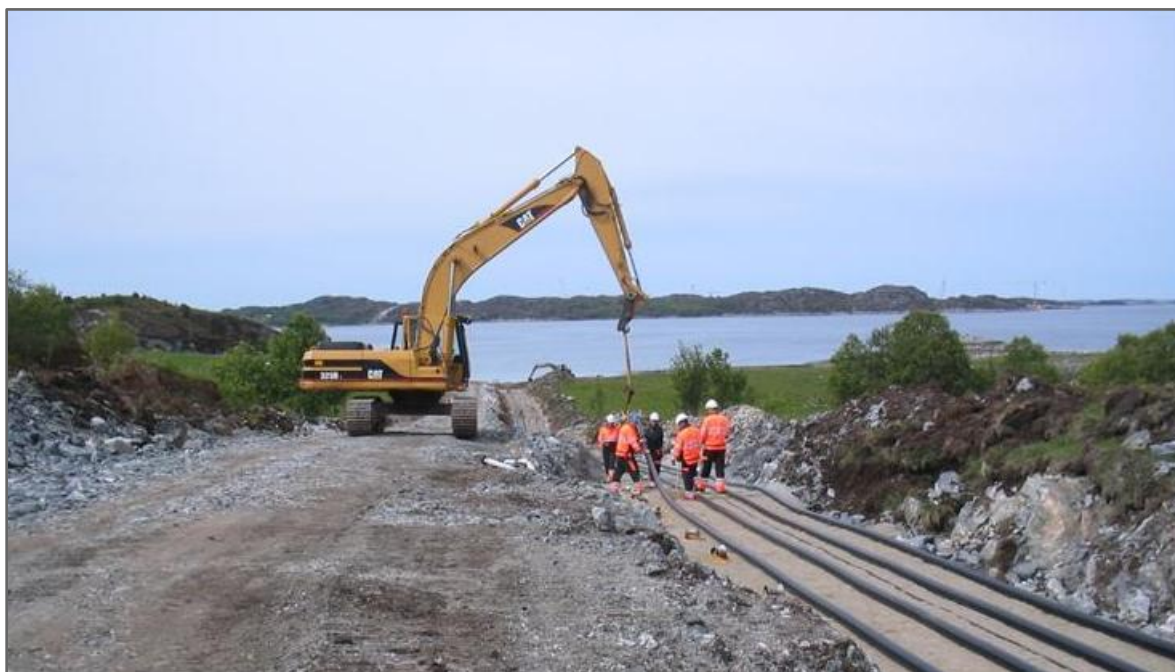
Figur 26: Bildet viser legging av et 420 kV kabelanlegg for vekselstrøm. Her legges det ett kabelsett (tre kabler) + en reservekabel. For å få noenlunde tilsvarende kapasitet på et kabelanlegg som planlagt ny 420 kV-ledning Skaidi-Varangerbotn, må det legges to kabelsett (seks kabler).
