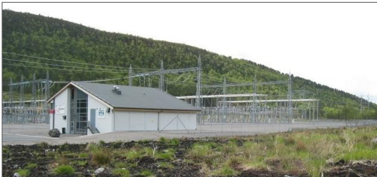
Figur 7: Bildet viser et eksempel på en 420/132 kV transformatorstasjon.
