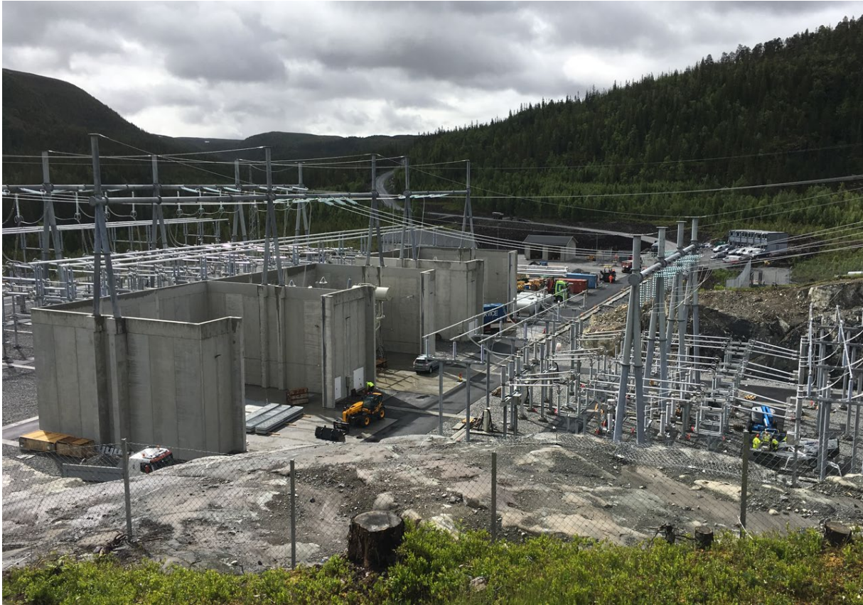
Figur 4: Eksempelbilde av transformatorsjakter i betong med 420 kV anlegg til venstre i bildet og 132 kV til høyre. Dette er fra Hofstad transformatorstasjon i Åfjord kommune.
