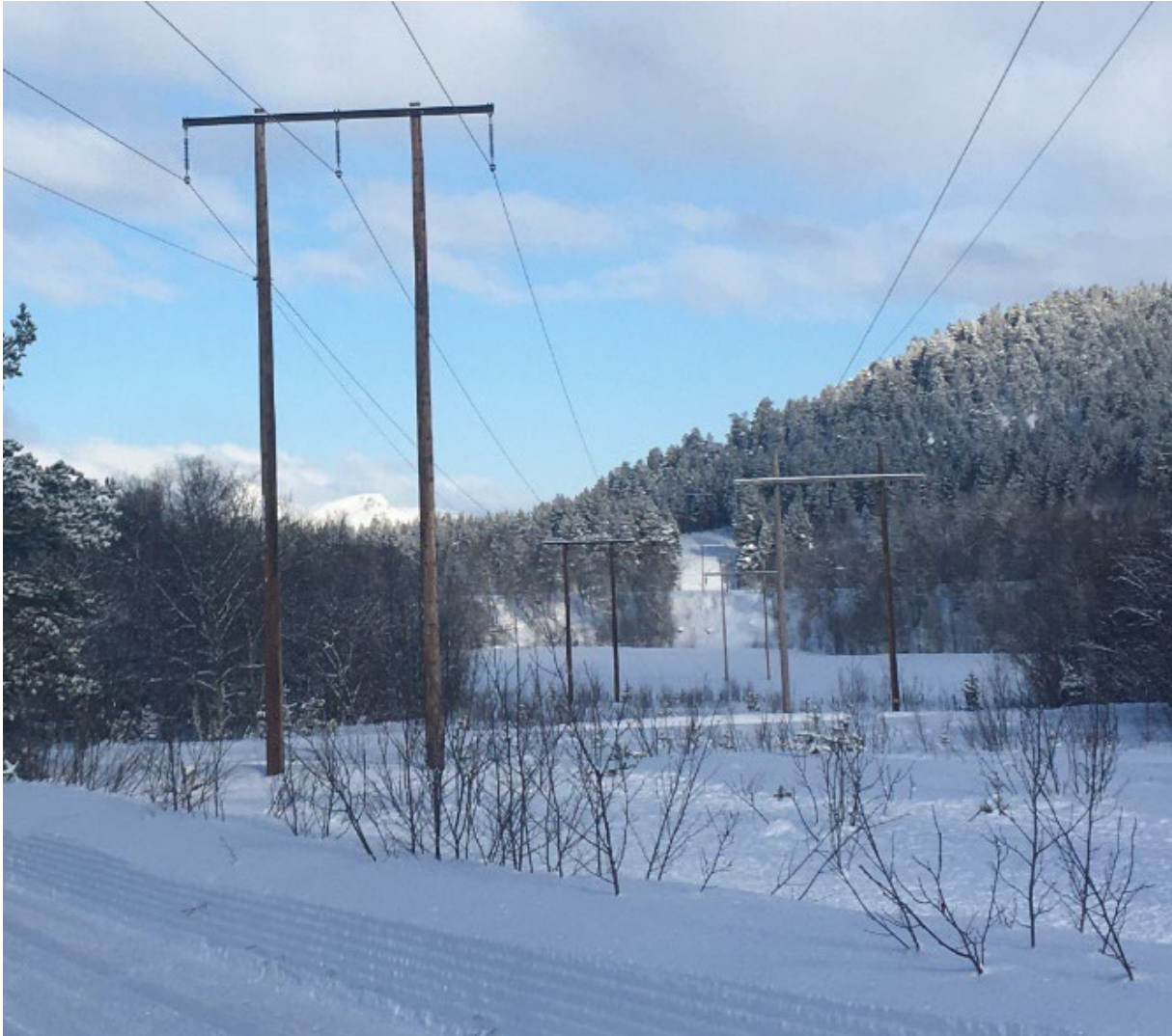
Figur 6: Eksempel på trestolpemast for 66 kV.
