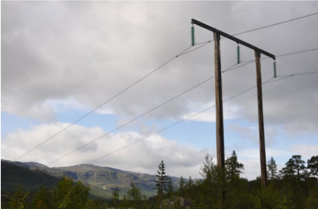
Figur 2: Foto 132 kV Alta-Kvænangen-Nordreisa tatt av Sissel Ribe, NVE. Foto hentet fra www.kulturminnesok.no
