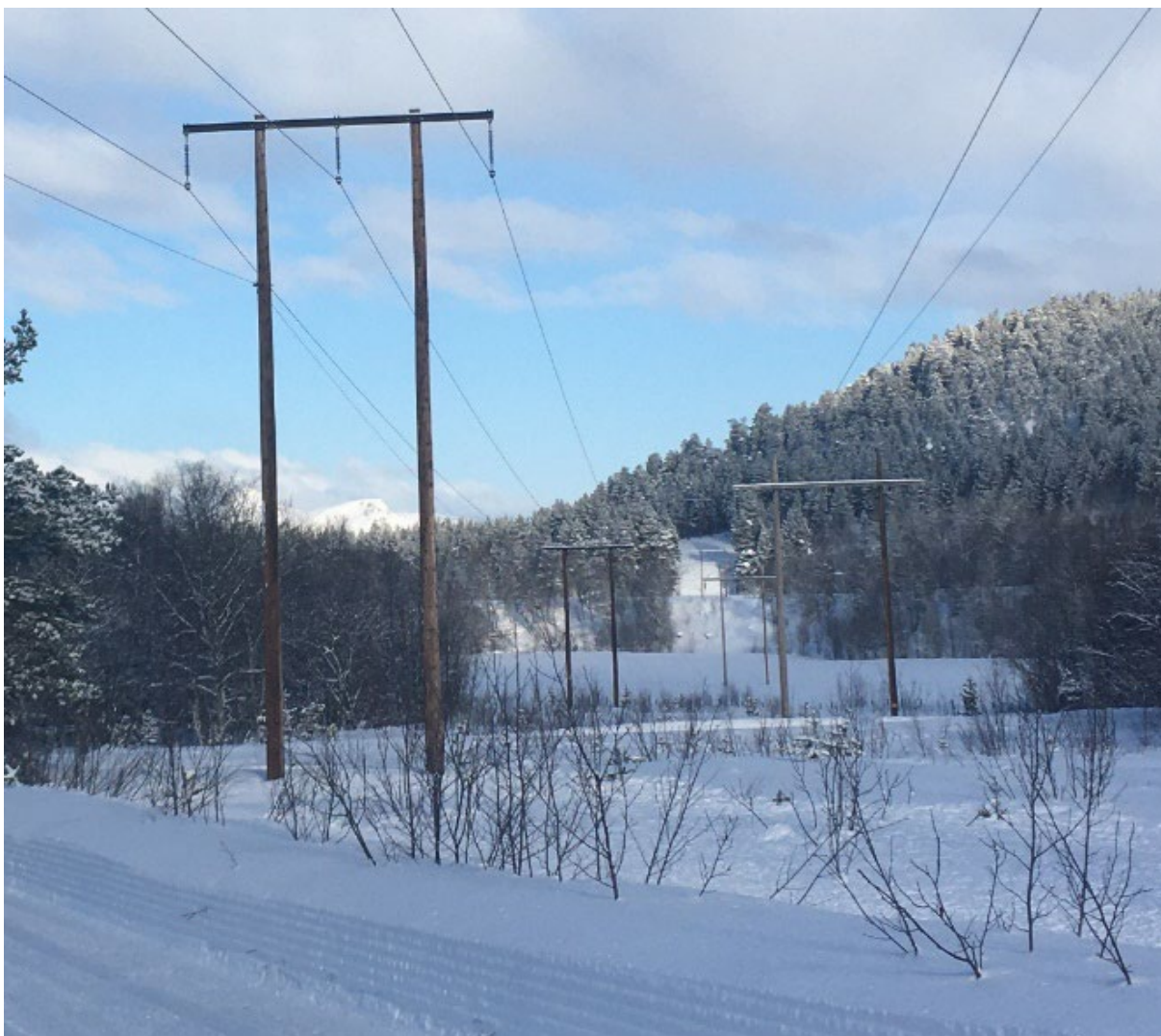
Figur 6: Eksempel på trestolpemast for 66 kV.
