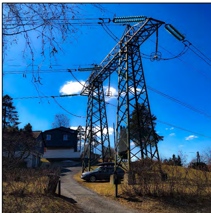
Foto over: Luftledning og mast i hagen ved KM 12. Foto: Jan Adriansen, Sweco
