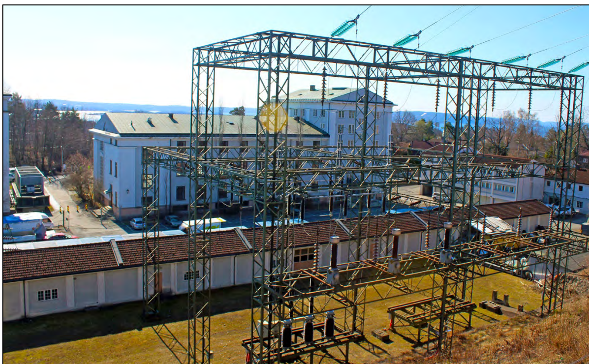
Smestad transformatorstasjon fra 1927 bak inntaket til 132 kV Nore – Oslo. Til venstre for bygget (utenfor bildet) ligger transformatorbygningen fra 1921. Foto: Jan Adriansen, Sweco.
