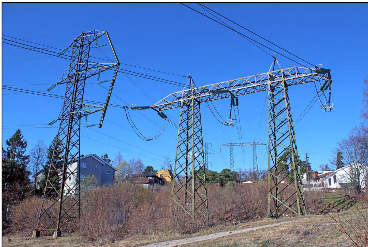
Mastene til 132 kV Nore – Oslo (til venstre) er høyere enn dagens 300 kV master til luftledningen Hamang – Smestad (til høyre). Foto: Jan Adriansen, Sweco.
