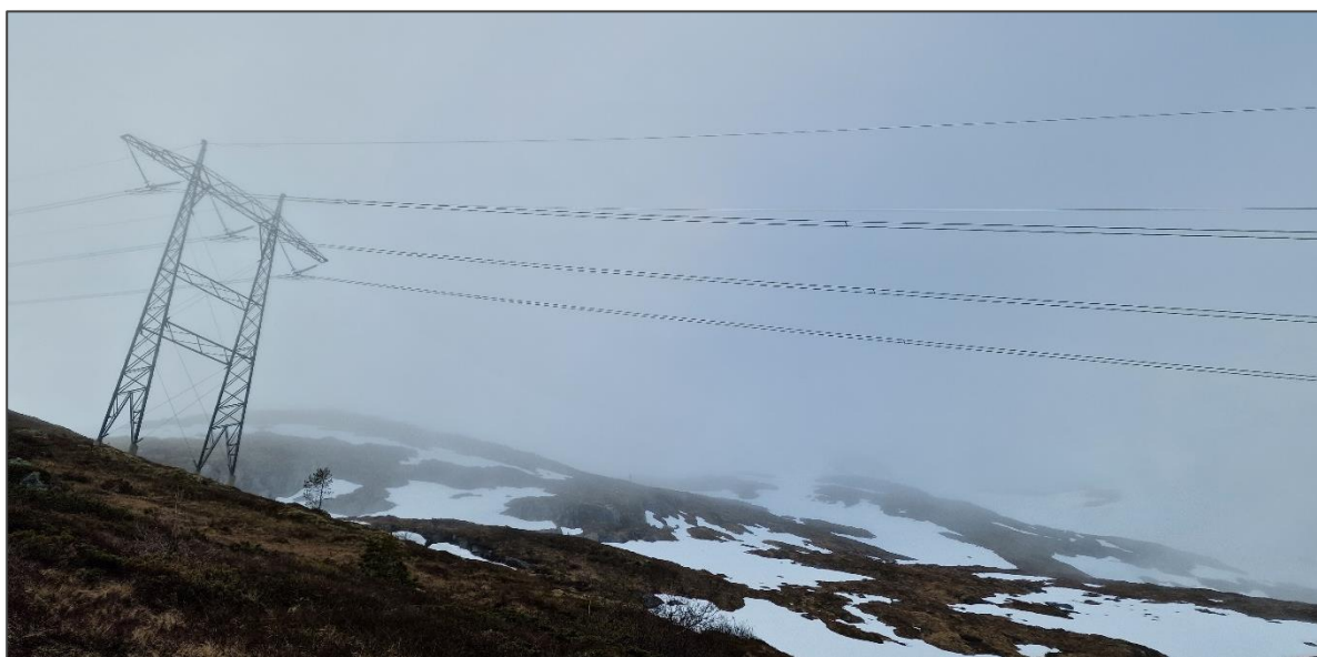
Figur 3-1. De tynne topplinene representerer en større kollisjonsrisiko enn de mer synlige faselederne. Dette eksemplet er hentet fra 420 kV Fardal – Ørskog (som er en duplex-ledning).
