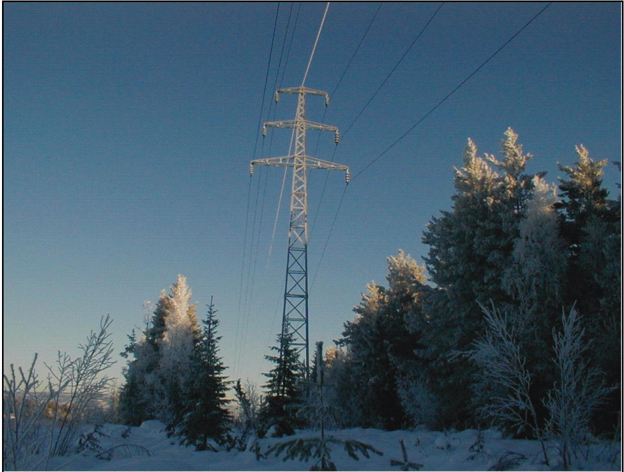
Figur 2. Bilde av eksisterende 66 kV-ledning Flesaker – Bevergrenda. Foto Buskerud Kraftnett.
