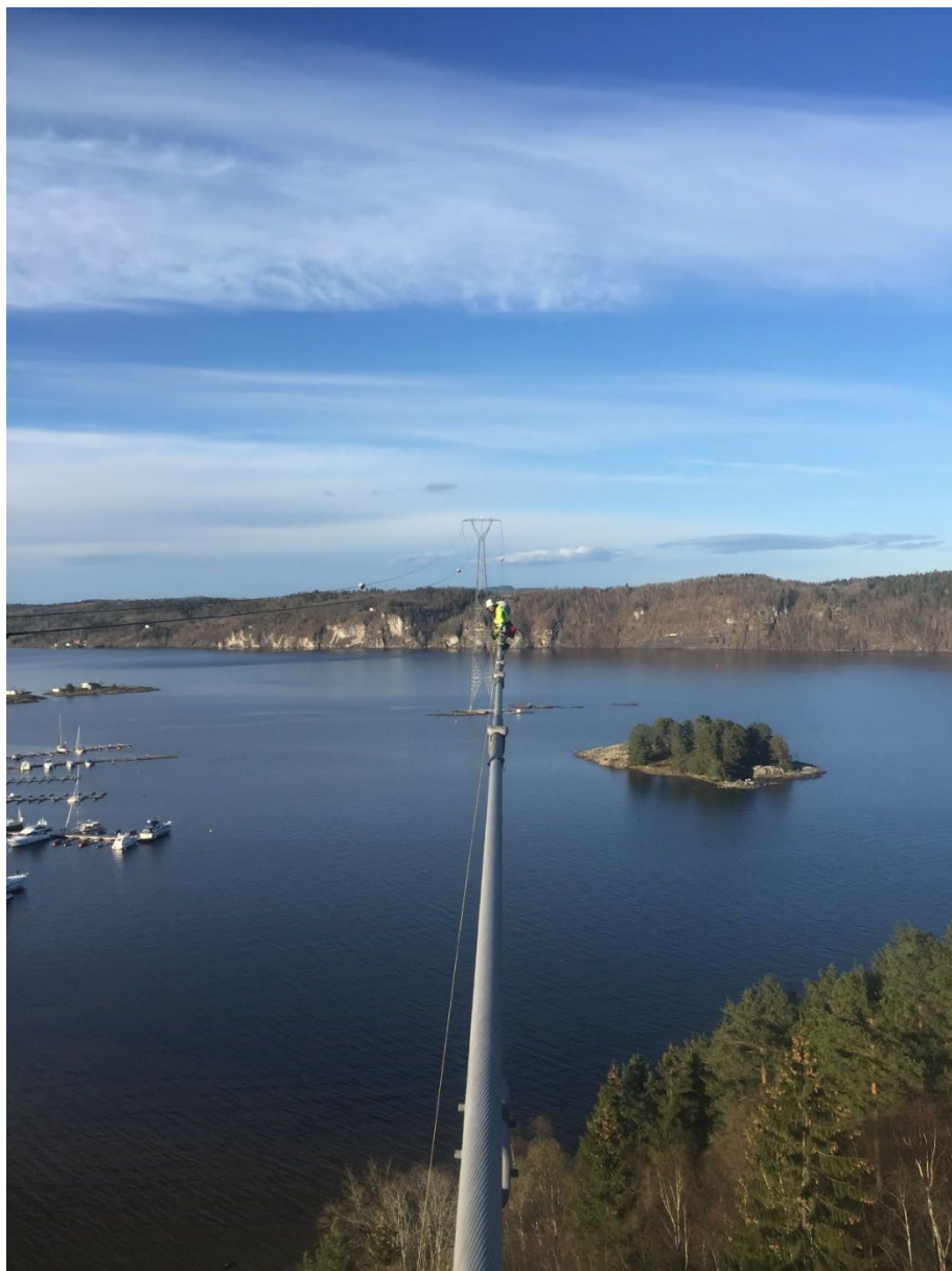
Figur 5 Ved kryssing av Frierefjorden, mellom Bamble og Porsgrunn kommune, meldes det nytt luftspenn sør for eksisterende 300 kV ledning. Nytt luftspenn vil inkludere hjelpemast på Garstadholmen som ses i figur over. Bilde: Statnett.
