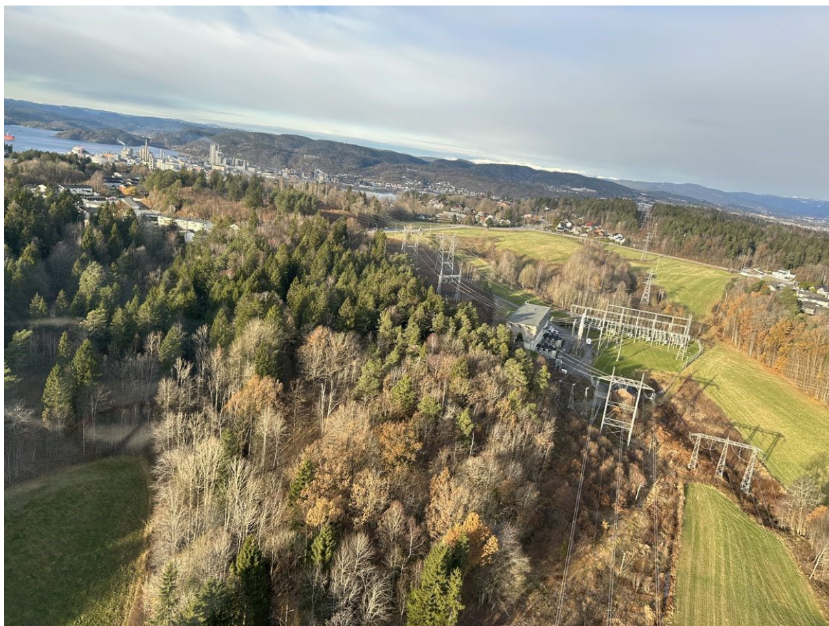
Figur 4 Eksisterende Porsgrunn transformatorstasjon. Skogen til venstre for stasjonen i bildet inngår som alternativ A for ny transformatorstasjon.
