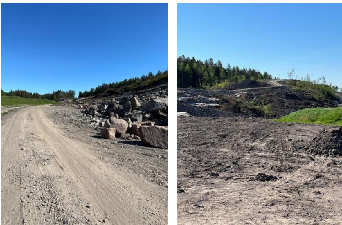
Figur 14 Anleggsvirksomhet Ødegården næringsområde (mai 2024). Bilde til venstre viser området øst for vei inn i området – bilde sett nordover. Bilde til høyre viser området øst for vei inn i området, og viser areal som skal planeres til næringsområde – bilde sett mot sørøst.
