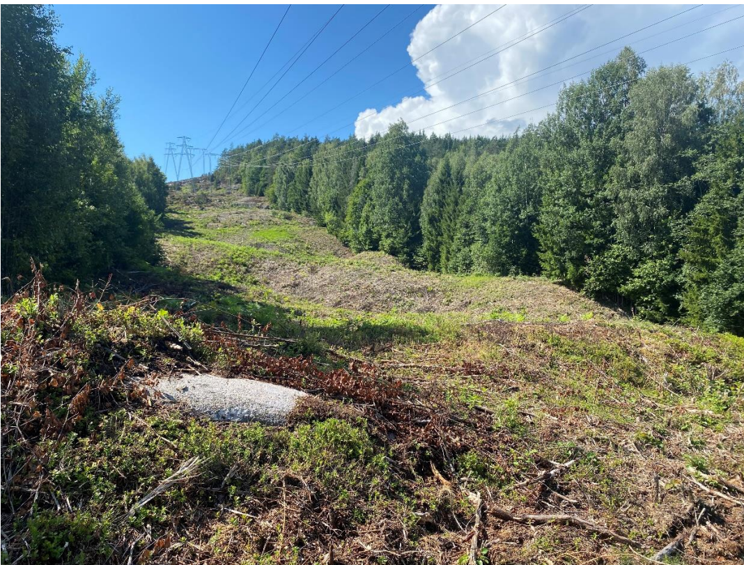
Figur 2-27. Bildet viser det ravinerte terrenget under kraftledningen øst for Gullåsen i august 2023. En av bekkene renner i ravinen i bakkant (Figur 2-28). Kraftgata er ryddet for vegetasjon sommeren 2023. Foto: Sweco Norge.
