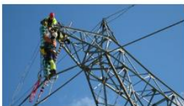
FERDIGSTILT Bjerkreim transformatorstasjon >
