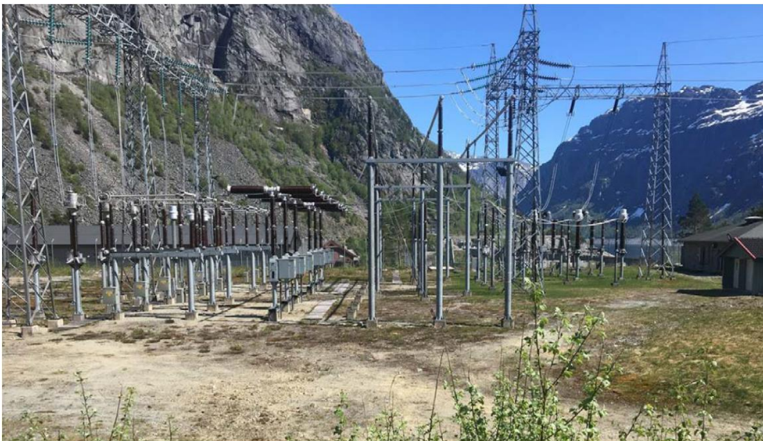
Figur 9: Dagens bryterfelt i Åsen. Nytt felt blir betydelig større da det dimensjoneres for 420 kV og av hensyn til forsyningsikkerheten bygges med doble samleskinner.
