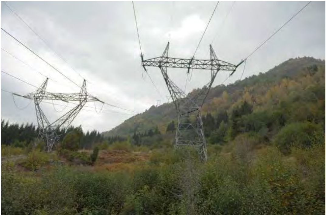
Figur 4-20 Eksisterende ledning sett fra veien ovenfor Uppheim mot Alpen. Her står mastene tett på veien.
