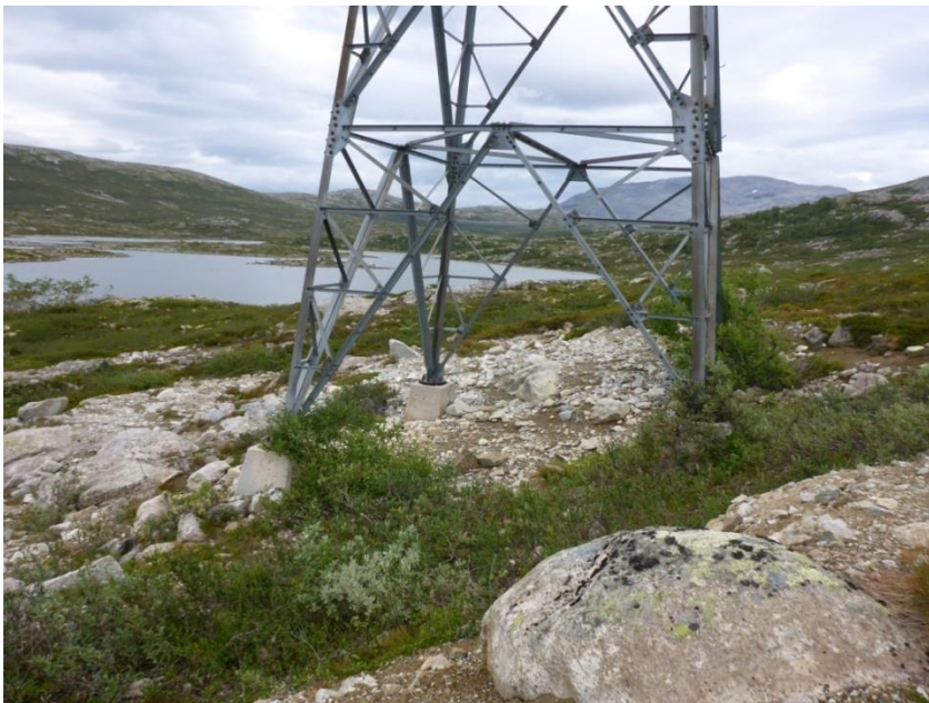
Figur 4-9. Mast ved nedre Storebotenvaten. Endrede forhold som følge av masta kan se ut til å ha gitt mer erosjon rundet mastefestet.
