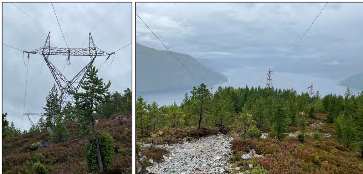
Figur 7-18: Listeført kraftledning Refsdal-Fardal sett fra Fimreite-siden (øst for fjordspennet).
