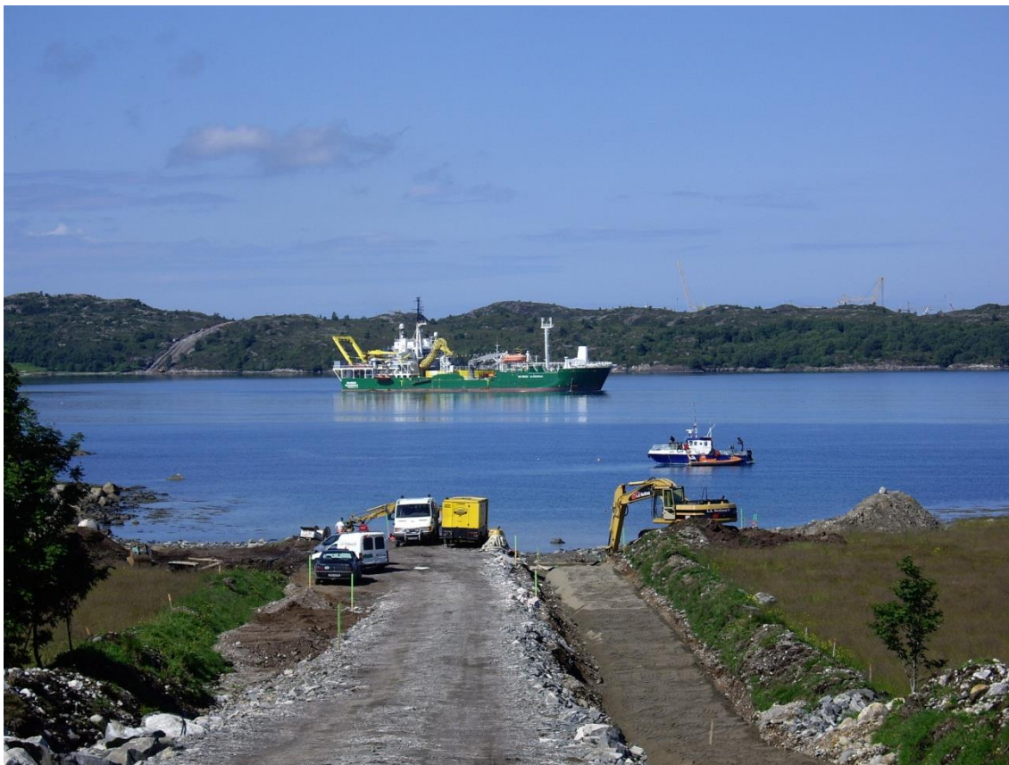
Bilde 4: Eksempel på anleggsbelte for 420 kV jordkabel med ett kabelsett + reservekabel (totalt 4 kabler) i overgangen mellom jordkabel og sjøkabel
