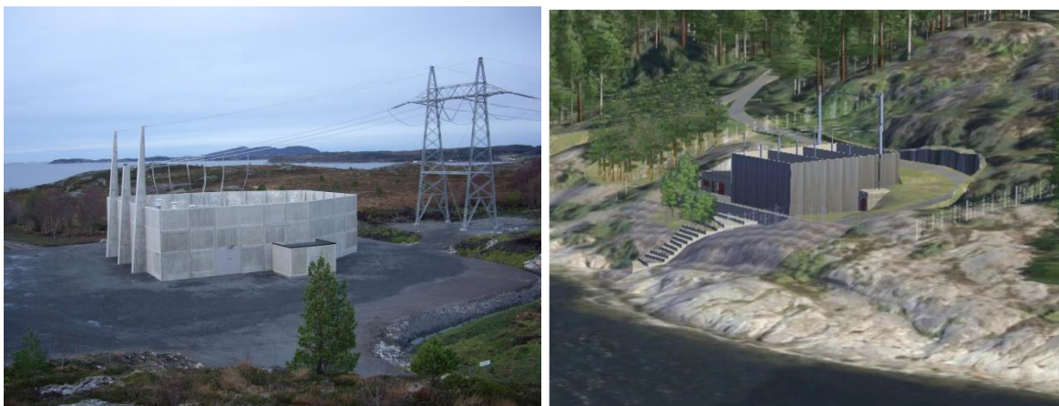
Bilde 1: Eksempel på muffestasjoner for overgang mellom kraftledning og kabel. Venstre bilde viser 420 kV for Nettilknytning Ormen Lange og høyre bilde viser en visualisering av 420 kV kabelforbindelse over Indre Oslofjord
