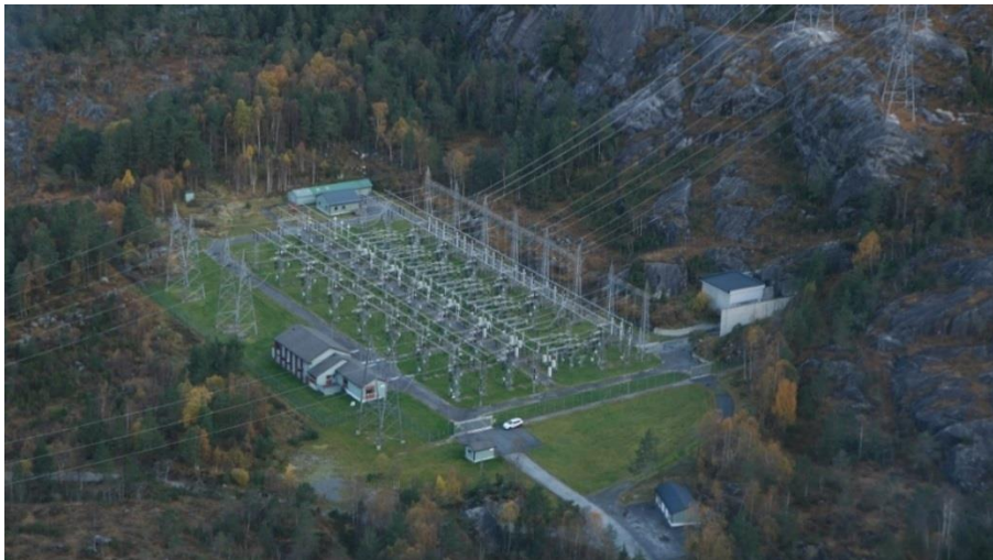
Figur 8: Blåfalli koblingsstasjon, med rom for mulig utvidelse sør for dagens anlegg.
