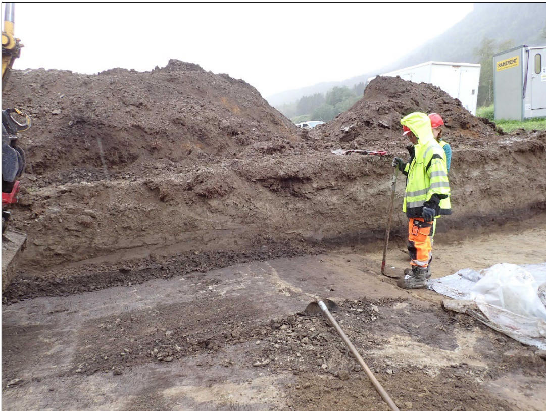
Figur 15. Flateavdekking på lokalitet 3, ser de generelt dype jordavsetningene som måtte fjernes med gravemaskin før vi kom ned på undergrunn. Sett mot sørvest.
