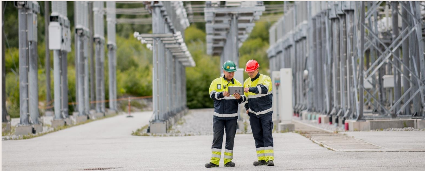
Enhetlige instruksjoner og prosedyrer for elsikkerhet er avgjørende i Statnett. Foto: Terje Borud/Statnett.
