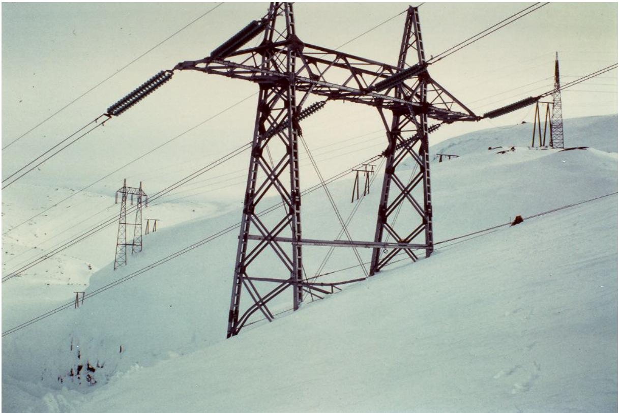
Figur 22: Mast ved Øvre Storvatnet, Bykle, med sigskader på bruene, snødybde ca 8 m.
