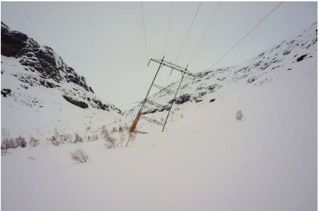
Figur 16: Skadet mast M36, Aasen-Røldal ca. 8. mars 2015.
