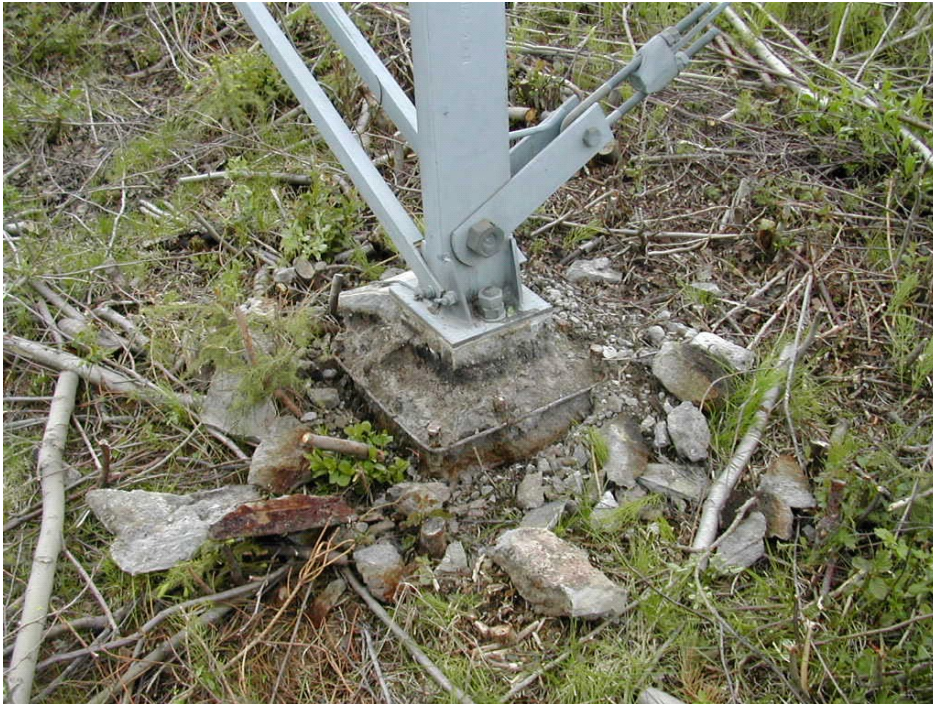
Figur 24: Frostnedbrytning av fundament.
