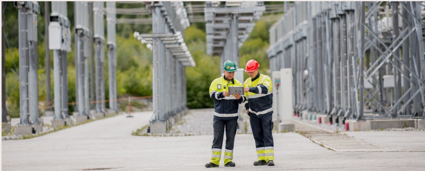
Enhetlige instruksjoner og prosedyrer for elsikkerhet er avgjørende i Statnett. Foto: Terje Borud/Statnett.
